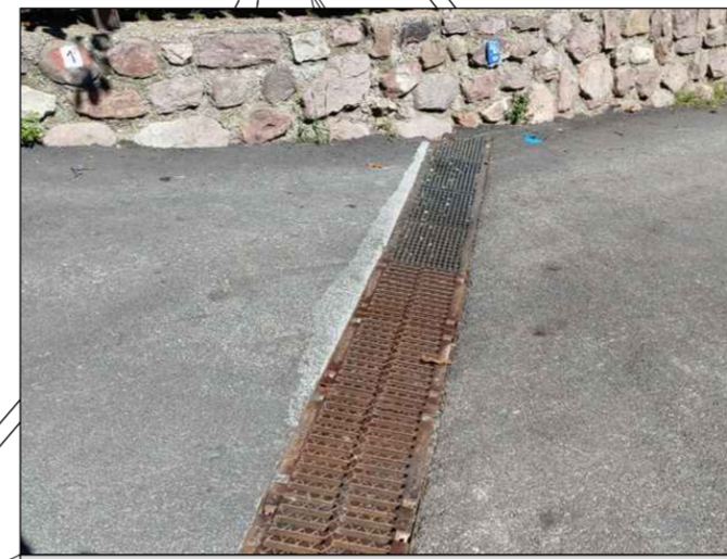
Fresatura e riasfaltatura per allineamento canaletta Fräsen und Neuasphaltieren für Anpassung Straßenrinne
